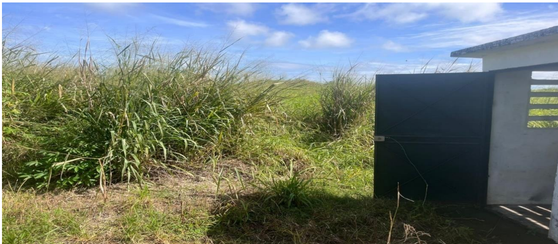
FIGURA N°32: Parte externa del pozo con la presencia de malezas a sus alrededores
