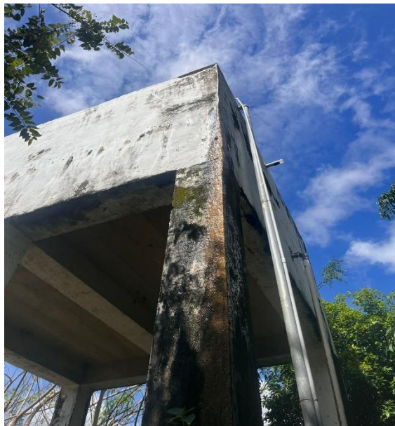
FIGURA N°30. Fisura en el tanque reserva
