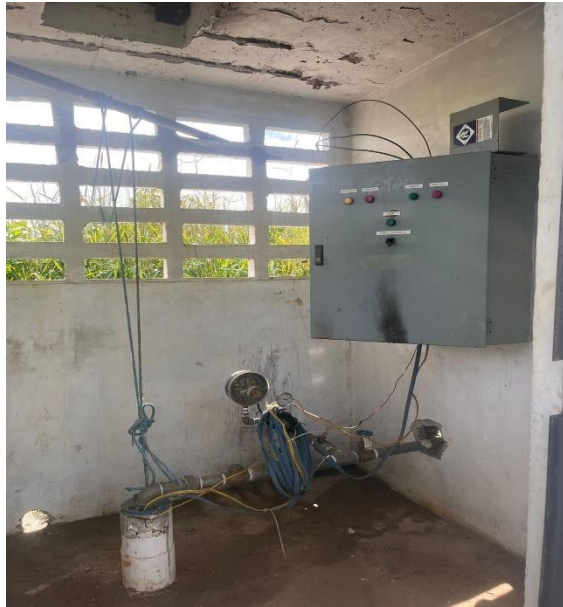
FIGURA N°33: Parte interna de la fuente hídrica
