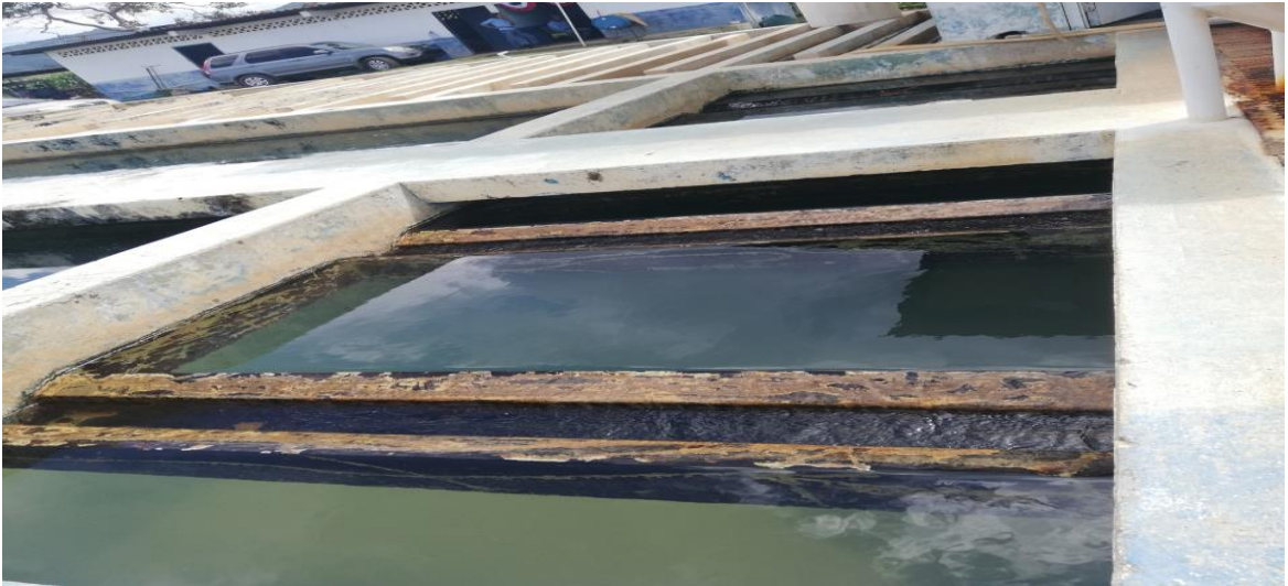
IMAGEN N°7. Sistema de Filtración y Cloración del agua en la Planta Potabilizadora de Macaracas Cabecera
