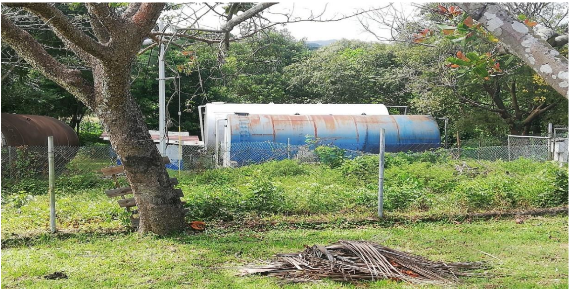
IMAGEN N°8. Sistema de Distribución del Agua Potable en la Planta Potabilizadora
