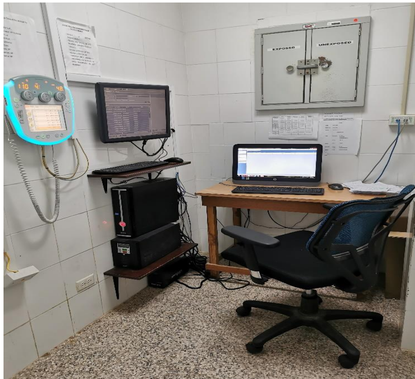
Equipo de radiología digital con su respectivo panel de control del Hospital Regional Dr. Rafael Estévez.
