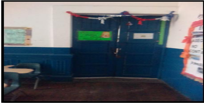
Figura N° 8. Salones dentro de otros y con salidas bloqueadas
