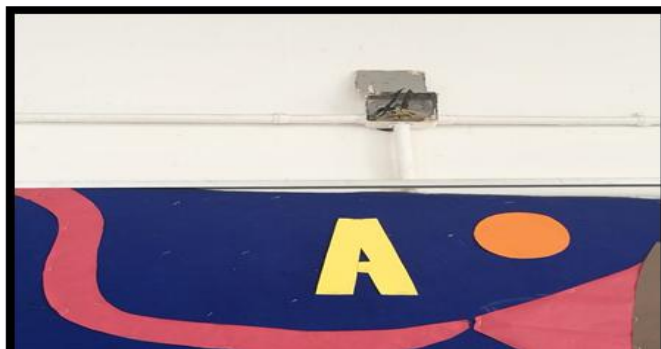
Figura N° 3. Enchufes eléctricos destapados y al alcance
