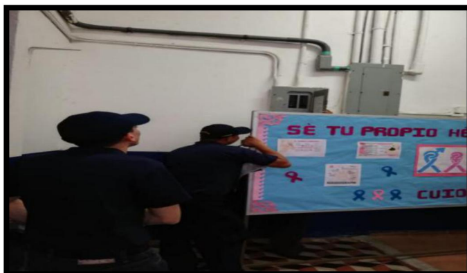
Figura N° 1. Caja de medidor abierta y sin rótulos
