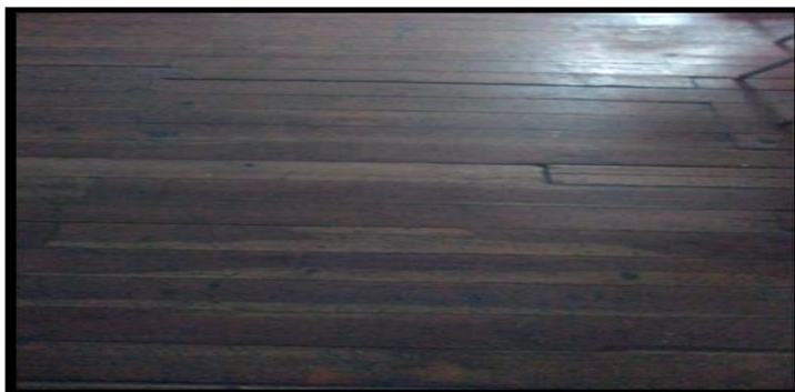
Figura N° 10. Pisos endeblés de madera
